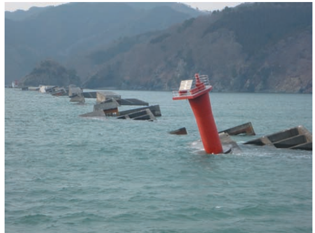
写真 22 倒壊した釜石湾口防波堤。
