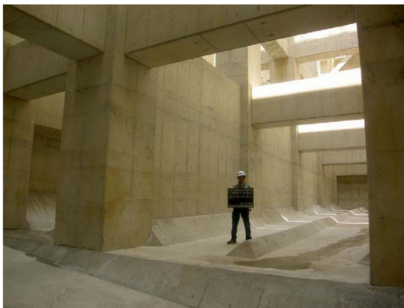
中央雨水ポンプ場雨水滞水池
